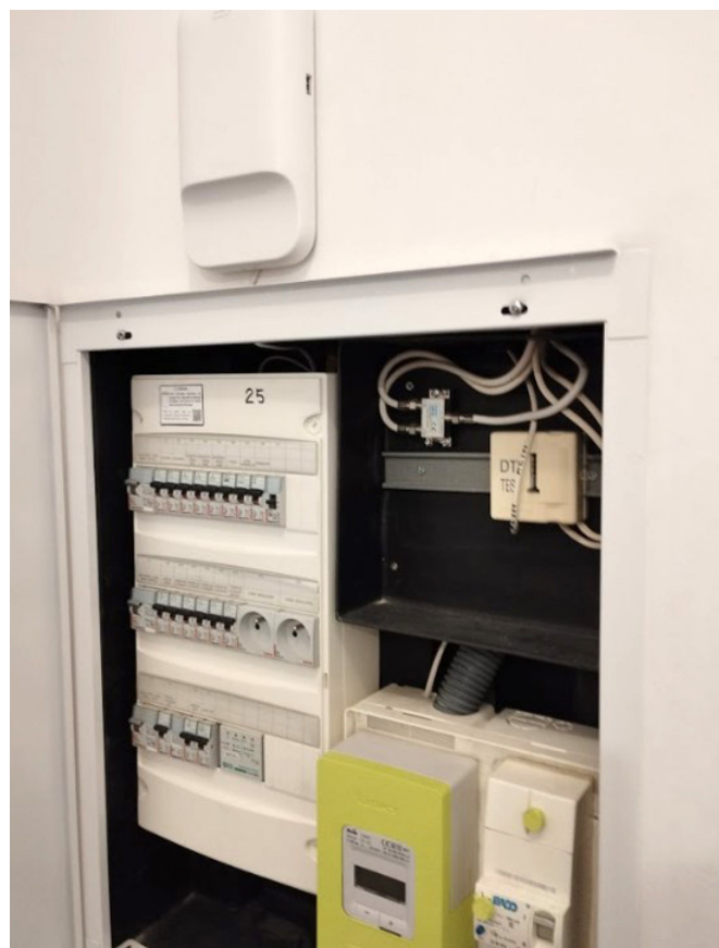
Borne de pilotage Voltalis installée au-dessus du tableau électrique.
