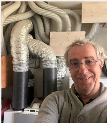
VMC, double flux avec récupérateur de chaleur, installée dans le cellier. Chaque pièce de la maison possède une bouche d'aération reliée à cette machine. Plus de 10 tuyaux.
