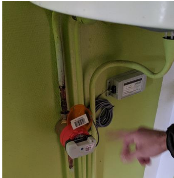
Ci-contre : Système de pilotage à distance et de collecte de données sous le ballon d'eau chaude électrique.
