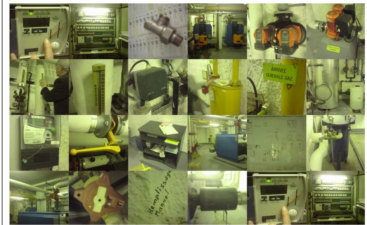
Photo n°51 : La visite de chaufferie avec un copropriétaire leader
