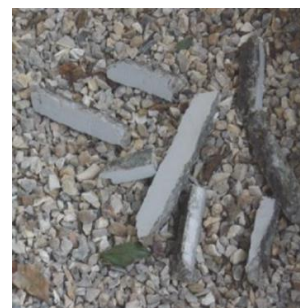
Photo n°48 : morceaux de béton tombés d'une façade
