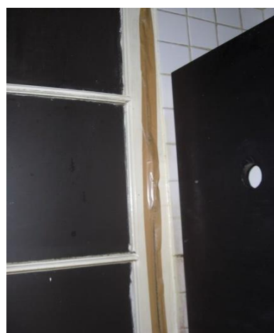
Photo n°30 : le scotch « isolant » la fenêtre
