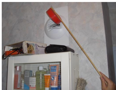
Photo n°29 : le « bouchon provisoire » de VMC
