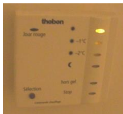
Photo n°41 : thermostat central électrique
