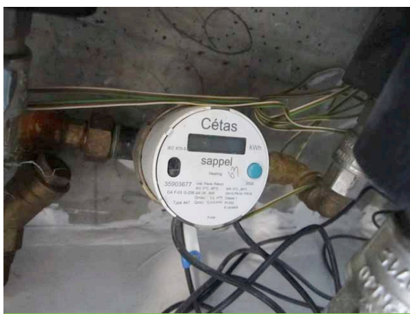
Compteur individuel de chauffage
