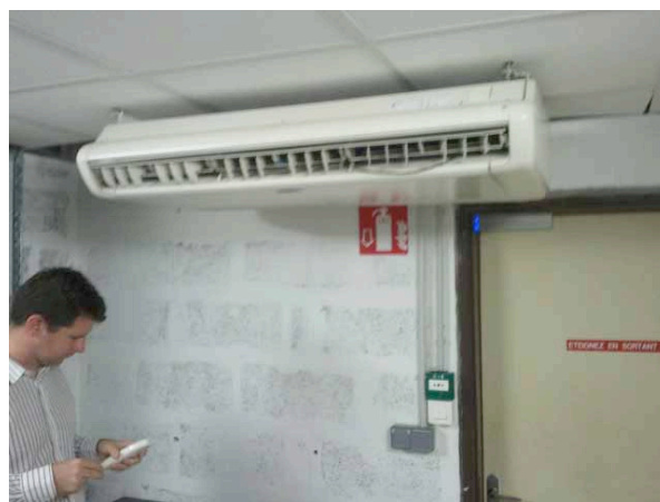
Climatisation de la salle des serveurs
