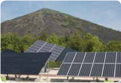
Inauguration centrale solaire
